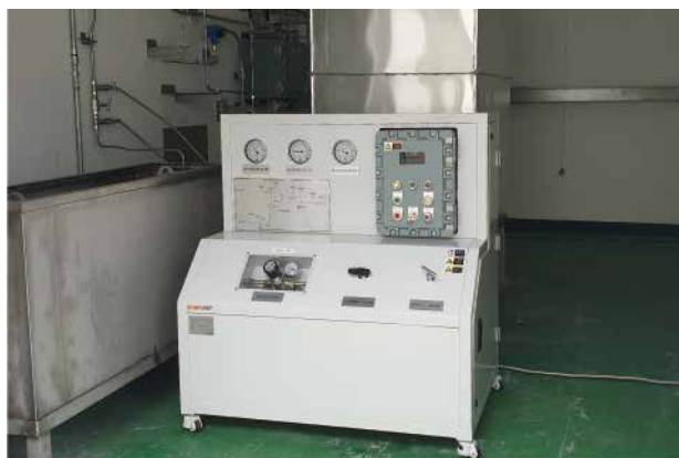
乙炔(C 2 H 4 )增压/再填充[500L级]设施
