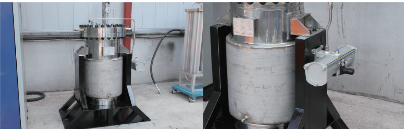
저압 컴프레셔 2차 증압·충진 설비 (TANK 재사용)
